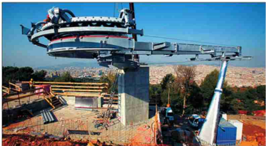
►► La estación superior, junto al castillo, sostenida por un soporte de hormigón y otro metálico inclinado.
