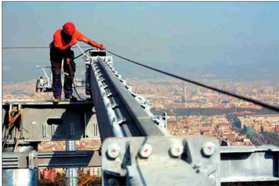
►► Un operario especializado en instalaciones alpinas trabaja sobre la estación superior, el pasado viernes.
